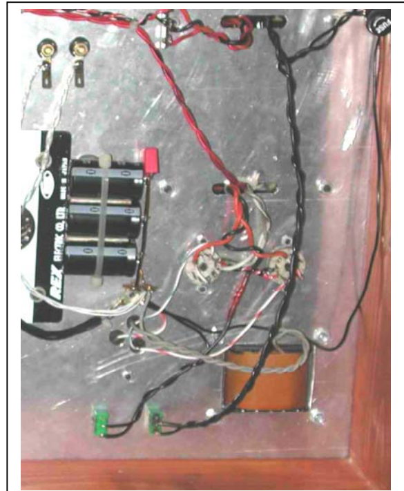
รูปการเดินสายส่วน Power supply
