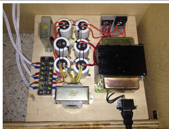
DC Power Supply สำหรับ Field Coil
